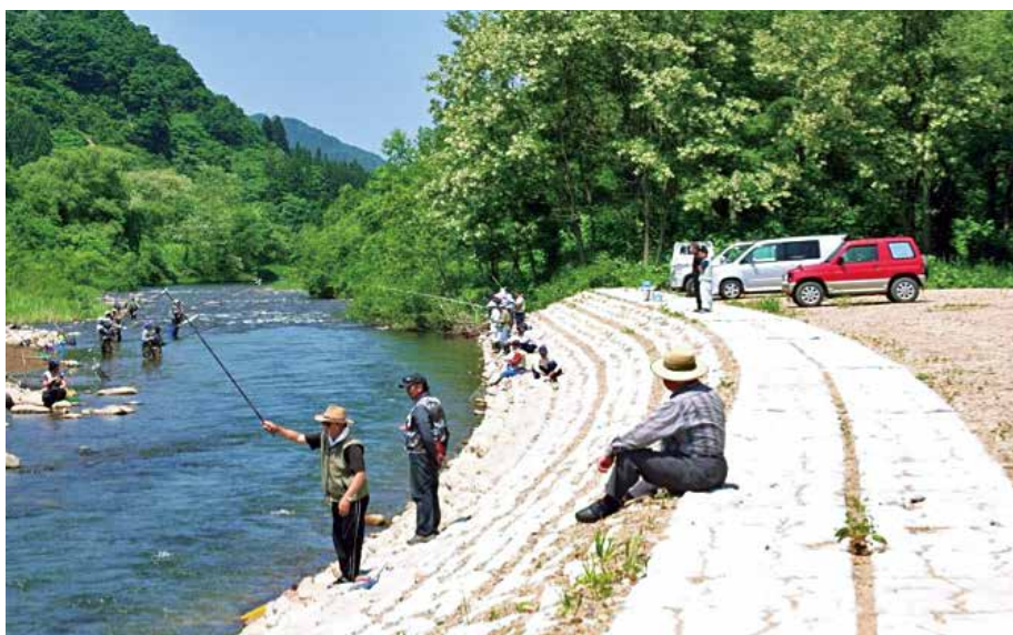
親水性に配慮し護岸工を実施した成瀬川（東成瀬村）
